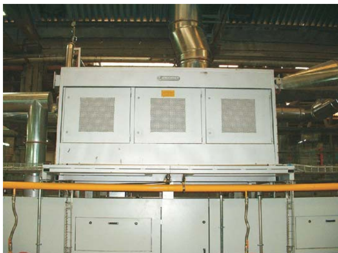
Bild 8 Wärmerückgewinnung durch back-pack (Brückner)
