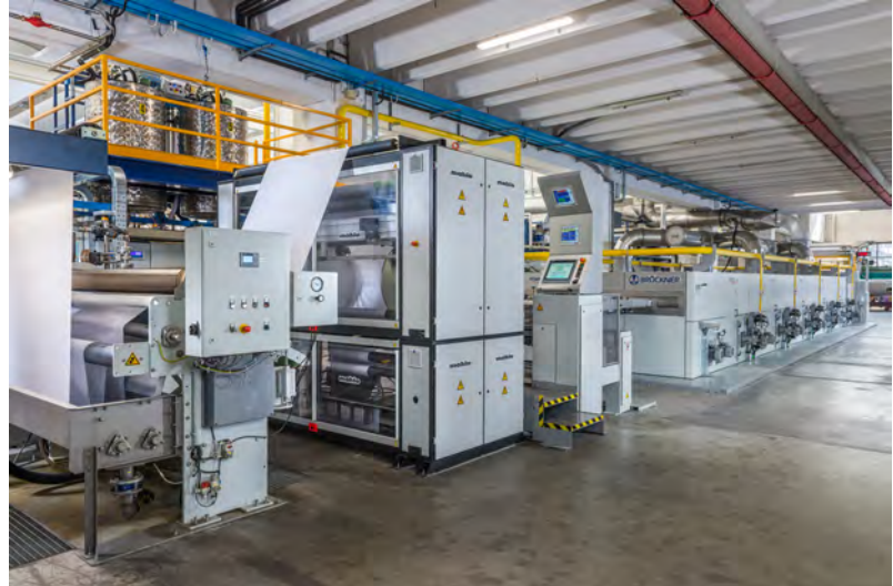
Mahlo-Kombianlage mit Orthomax RFMB und Prozesskontrolle Optipac VMC an einem Spanrahmen im Finishing-Bereich.
